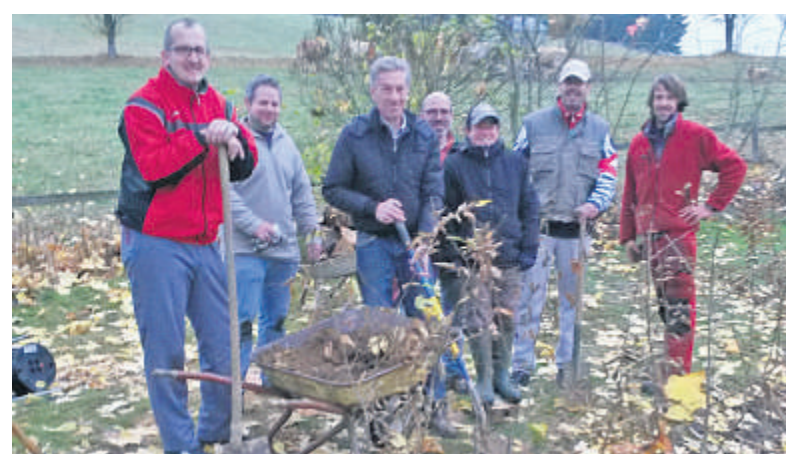
Eltern beteiligen sich am Bau des Grünen Klassenzimmers. Nach Möglichkeit soll im Frühjahr das Projekt voll durchstarten.
